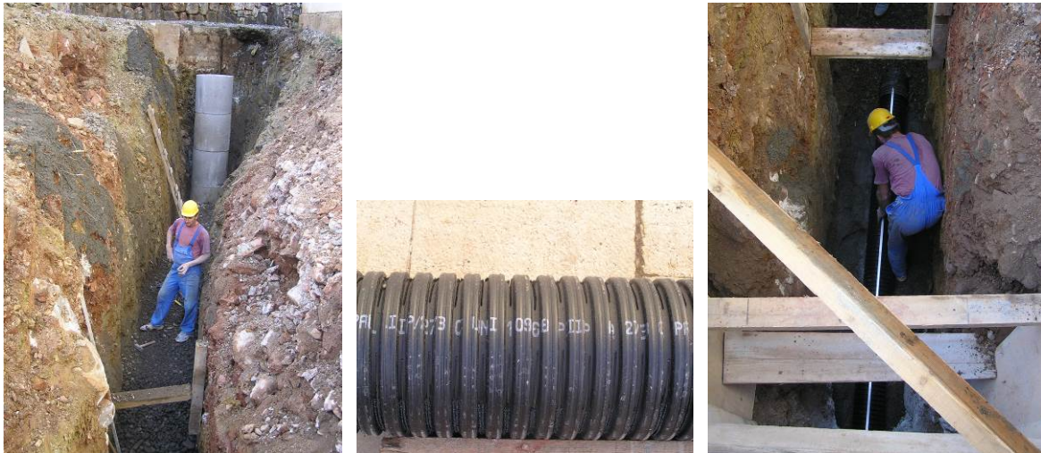
Slika 5. Drenažna zavjesa - Fotodokumentacija
