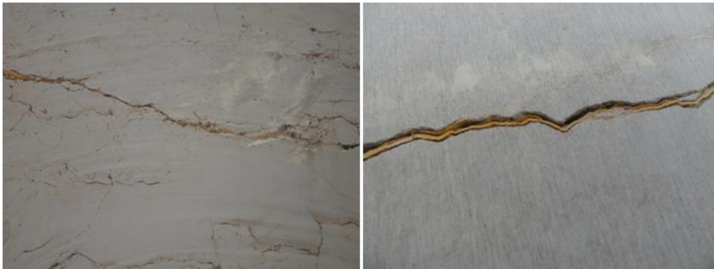
Slika 14. Prikaz nezapunjenih pukotina, s lističavim ljepilom
