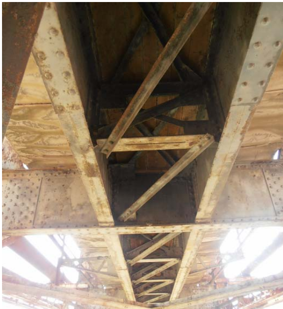
Slika 9. Spreg protiv bočnih udara na mostu u Gabeli
