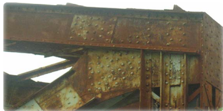
Slika 18. Primjer korozije na mostu
